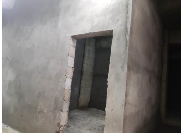
拟建直线加速器西侧质控间
