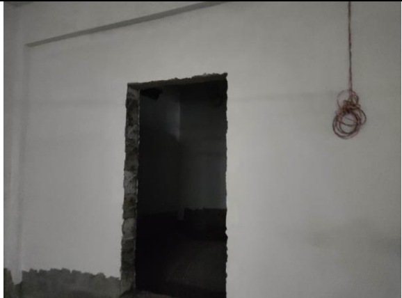
直线加速器西侧配电间
